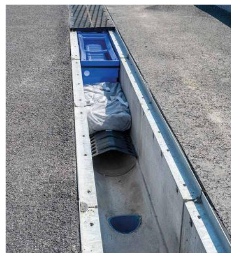
Nach der Grobreinigung in der Sedimentationsbox wird das Regenwasser in der Filtereinheit gereinigt und dann über Ablaufpunkte im Rinnenkörper abgeleitet
