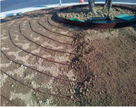
Gezielte Tropfbewässerung versorgt Wurzeln optimal und wassersparend
