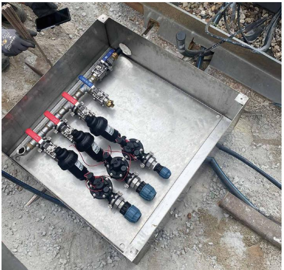
Elektronisch gesteuerte Ventile in Kombination mit Sensorik und zentraler Steuerung reduzieren den Arbeitsaufwand auf ein Minimum
